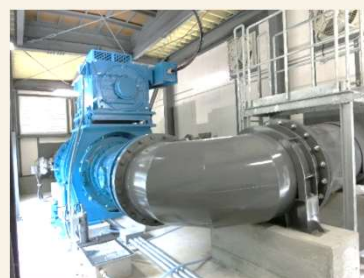
上追沢沈砂池の小水力発電設備
