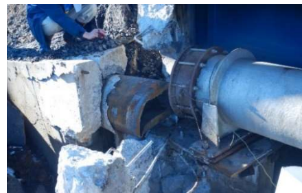
地震により破断した水道管（令和６年能登半島地震）
