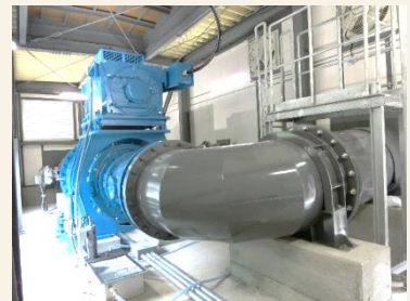
上追沈砂池の小水力発電※ 3 設備
