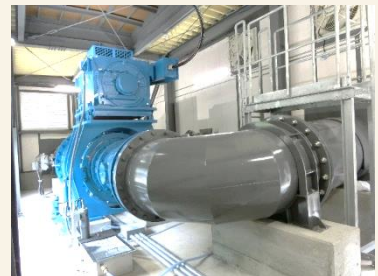
上追沢沈砂池の小水力発電設備
